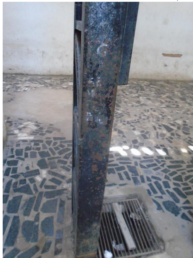
Imagem 26 – Imagem do pilar enferrujado. Fonte: COPROJ-SEINF.
