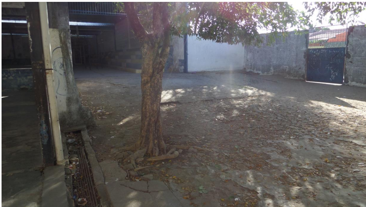
Imagem 06 – Foto tirada in loco da rampa de acesso às quadras com inclinação inadequada. Fonte: COPROJ-SEINF.
