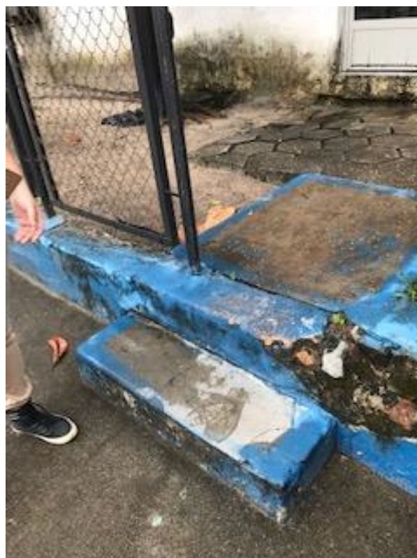
Imagem 03 – Foto tirada in loco dos degraus da escada na entrada da escola. Fonte: COPROJ- SEINF.
