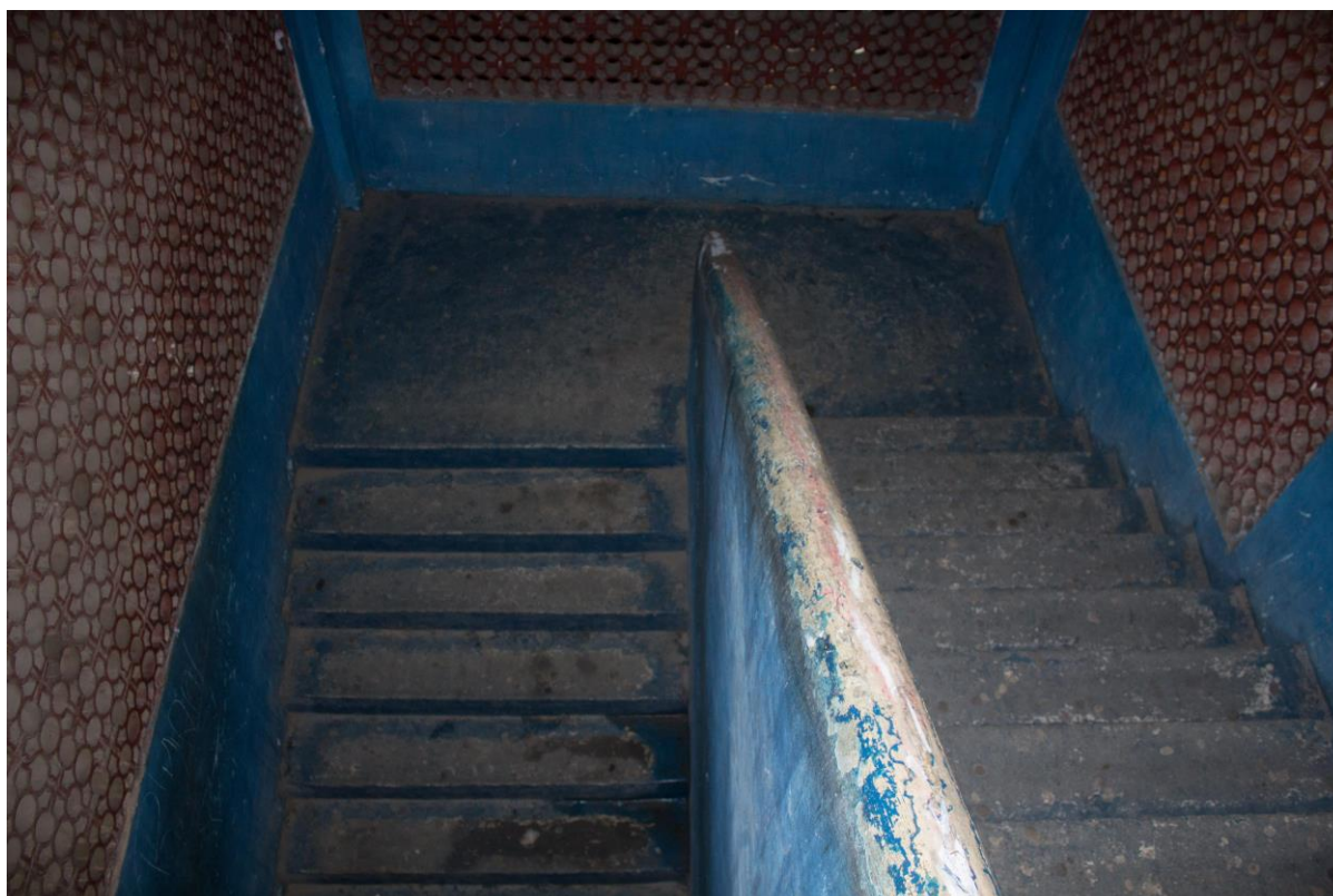
Imagem 05 – Foto tirada in loco da escada sem corrimão. Fonte: COPROJ-SEINF.
